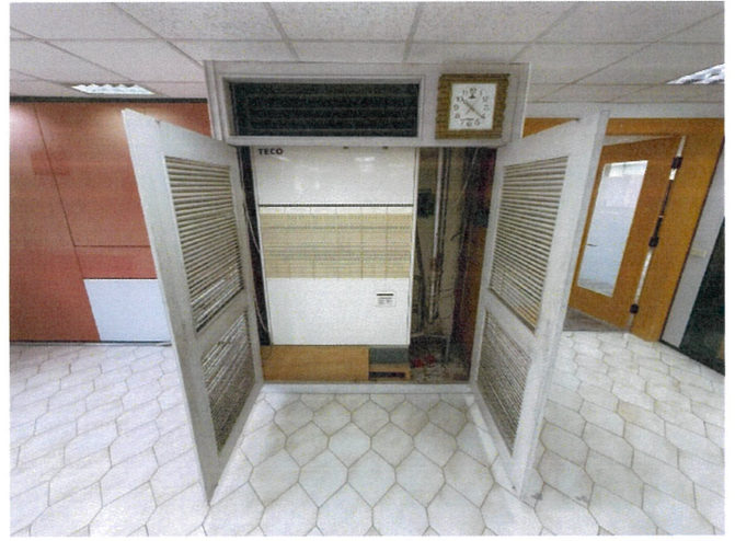
東元箱型冷氣(已故障), 本處不再辦理修繕, 現況點交, 原況返還。
