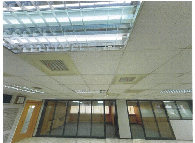
大金冷氣室內機出風口
