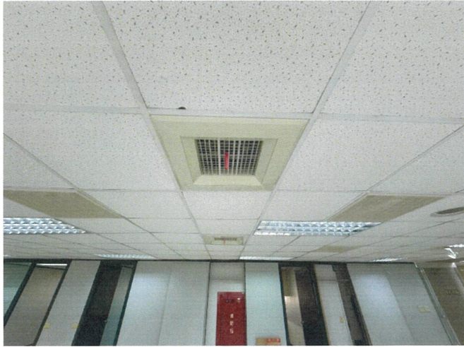
大金冷氣室內機出風口
