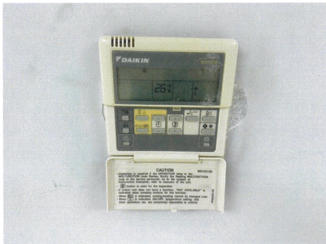
大金冷氣室內機開關
