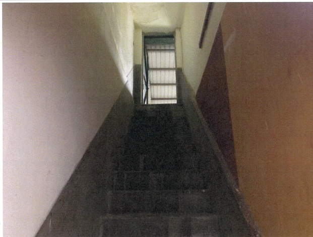
樓梯部分電燈不亮，線路不通
