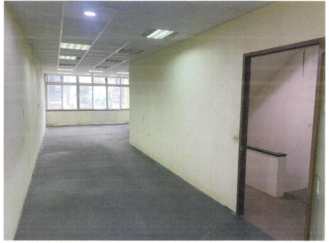
3樓部分電燈不亮
