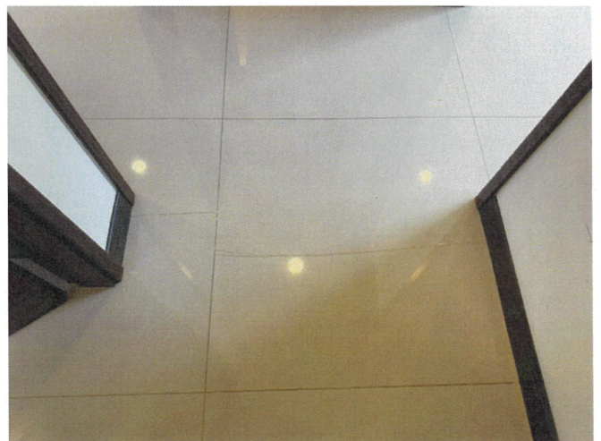
走道地磚有裂痕
