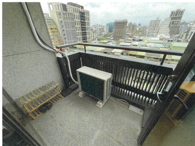
前陽台冷氣室外機為前租客留下，不列入設備點交範圍，本處亦不辦理修繕。
