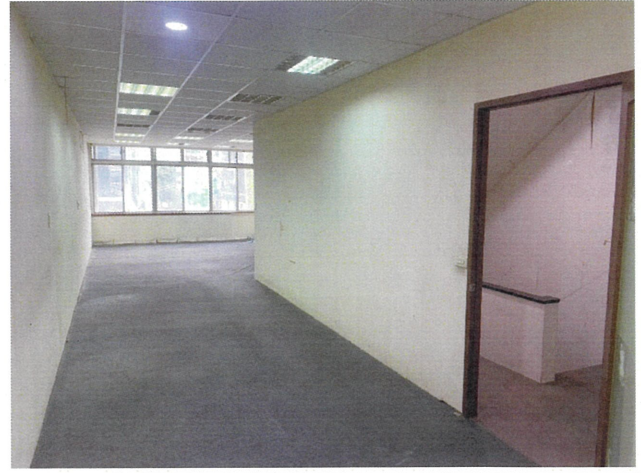
3 樓部分電燈不亮
