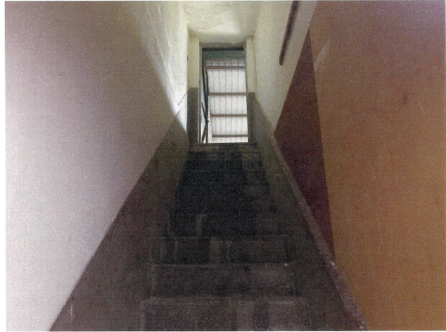
樓梯部分電燈不亮，線路不通
