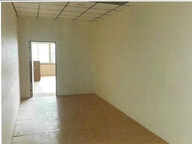
4 樓部分電燈不亮，線路不通
