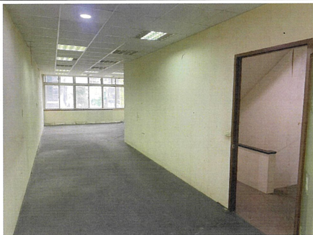
3 樓部分電燈不亮
