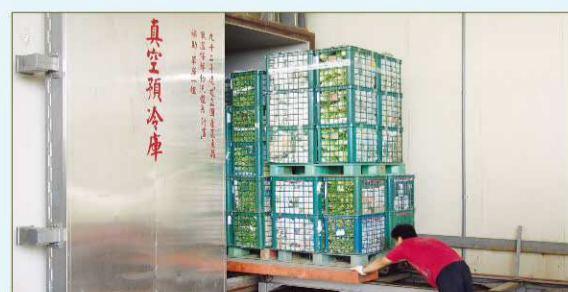
◎ 冷凍冷藏設備
