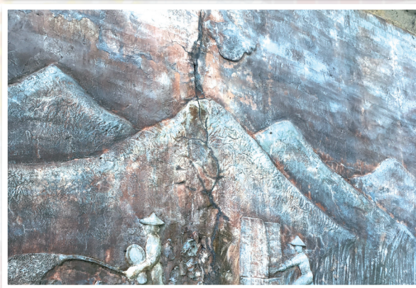
▲ 舊壁畫春耕圖斑駁龜裂狀況嚴重
