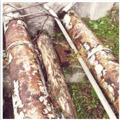
▲大豐抽水廠原有輸水管線鏽蝕嚴重
